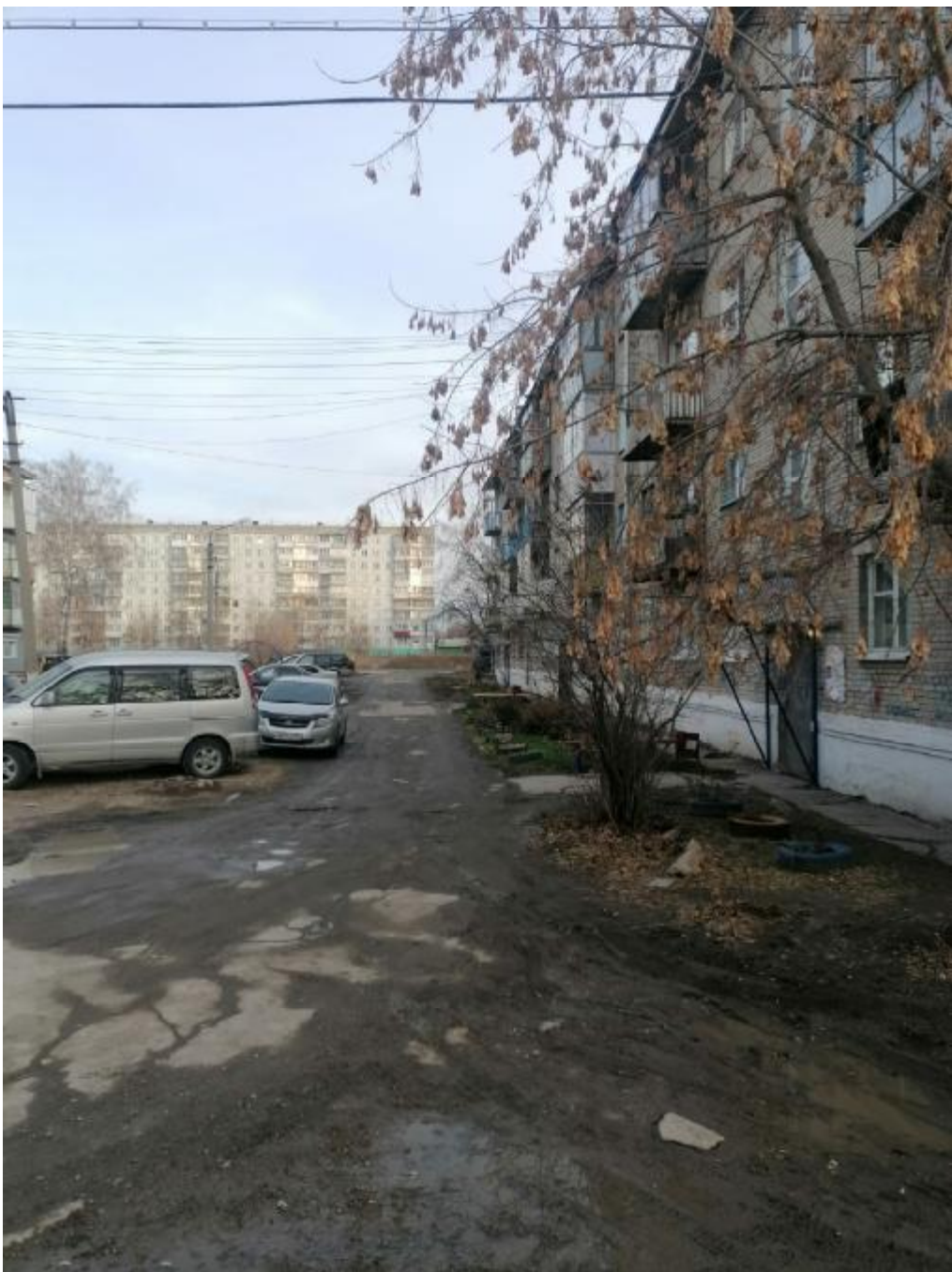
Проезд разрушен, оголено основание, подход к подъездам разрушен.
