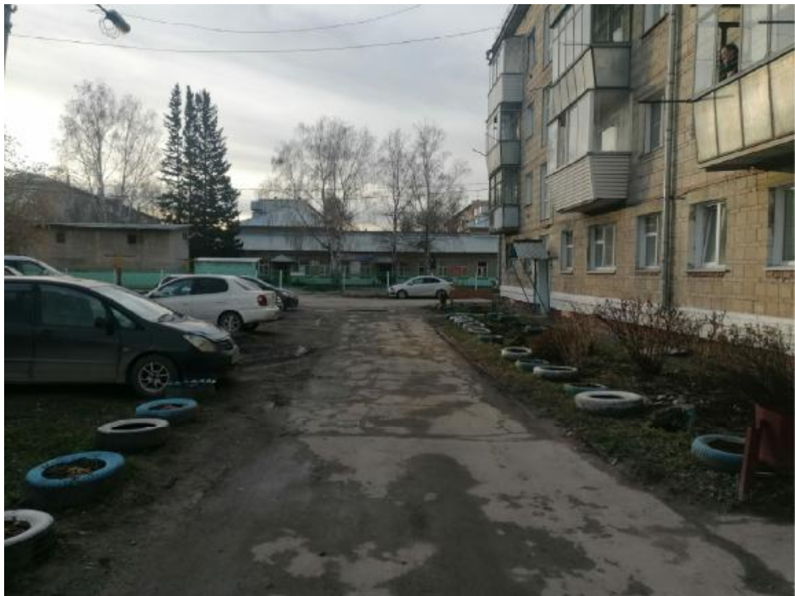
Проезд разрушен, оголено основание, подход к подъездам разрушен.
