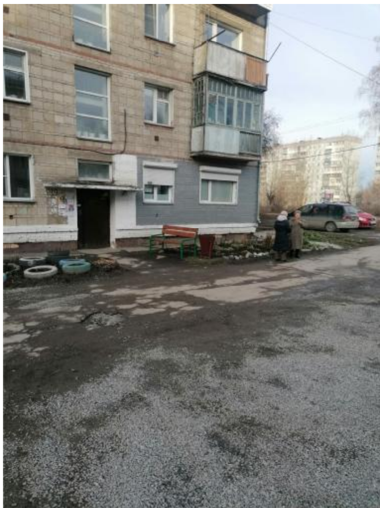
Подход к подъезду - разрушено а/б покрытие (имеются трещины, разрывы, разрушение, оголен нижний слой а/б)
